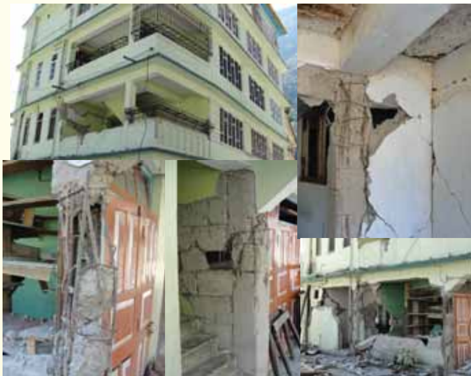
आकृति 4 : चुंगथांग (सिक्किम) में आरसी भवन की प्ररूपी विफलता
